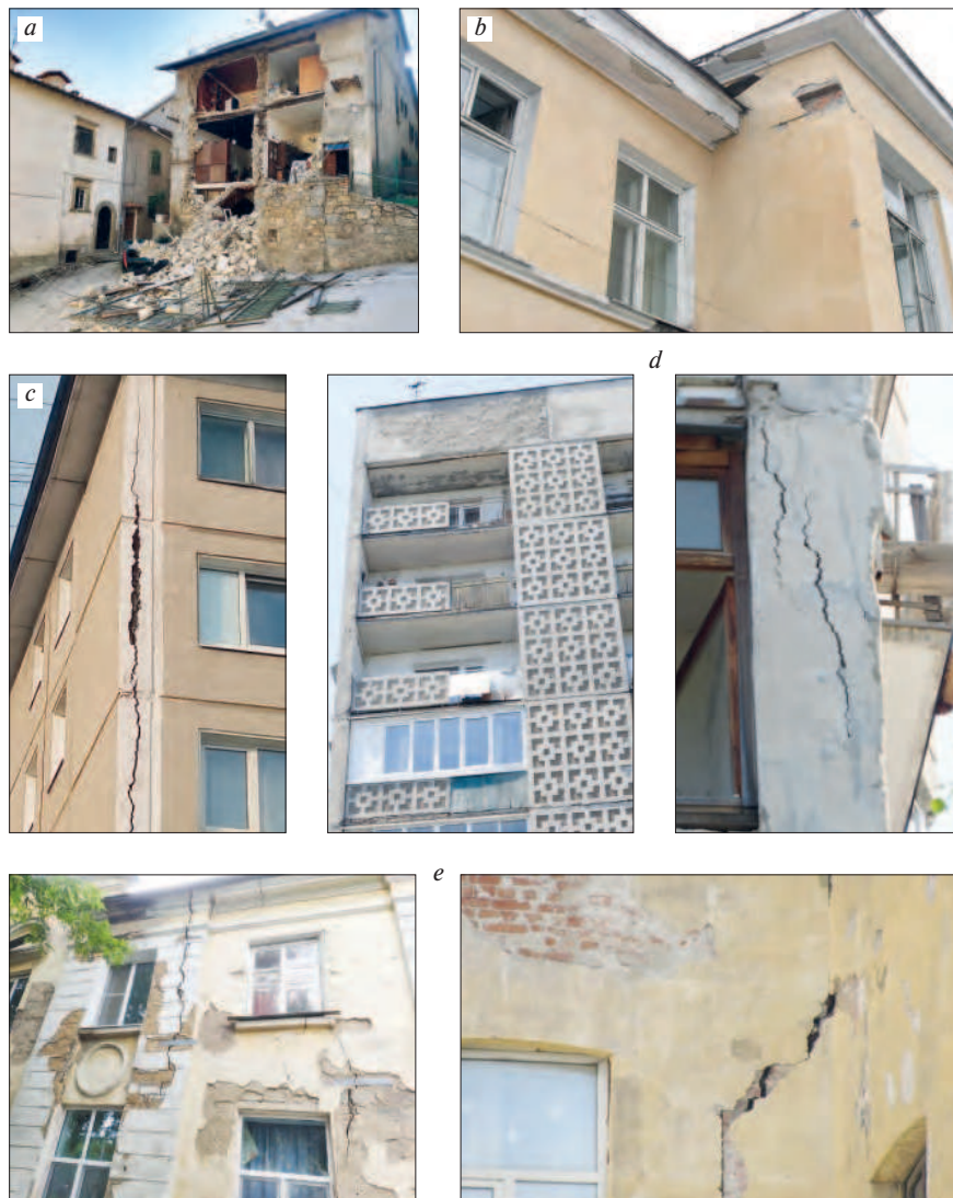
Рис. 2. Характерные повреждения при эксплуатации строительных объектов на сейсмически активных территориях (2008–2019 г.): а – обрушение фрагментов и конструкций малоэтажного жилого дома (г. Дербент, Республика Дагестан, годы постройки – 1935–1950); б – повреждения двухэтажного кирпичного здания школы (пос. Култук, Иркутская обл., год постройки – 1959); в, д – повреждения многоэтажных панельных домов из газозолотона (в – пятиэтажный типовой серии 1-335 КС, г. Ангарск, год постройки – 1972; д – девятиэтажный типовой серии И-163.02, г. Ангарск, год постройки – 1981); е – повреждения зданий исторической застройки (г. Ялта, Республика Крым). Источники фотографий: tvc.ru/news/show/id/161062 ; idei.club/61267-treschina-v-mnogokvartirnom-dome-54-foto.htm
