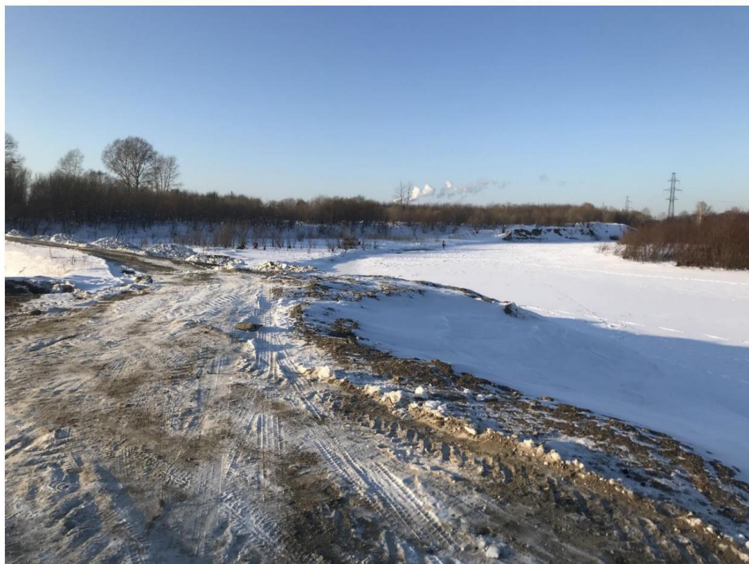
Рисунок 8 – Фотофиксация. Разрушенный участок дамбы (в сторону т. 18)
