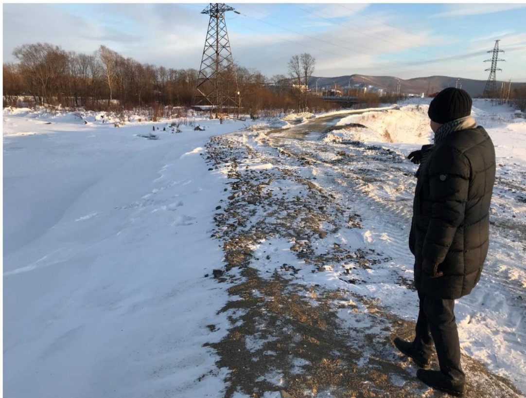
Рисунок 9 – Фотофиксация. Разрушенный участок дамбы (в сторону т. 19)
