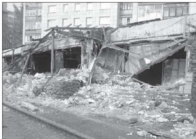
Рис. 2. Последствия пожара в здании ночного клуба (Пермь, 2009 г.)
