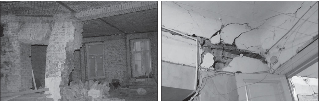
Рис. 3. Обрушение в результате вырубки проема в несущей стене жилого дома в процессе самовольной перепланировки, Санкт-Петербург ( https://soglas-proekt.ru/infoblog/Kamennooostrovskiy-57-samovolnaya-pereplanirovka/ )
